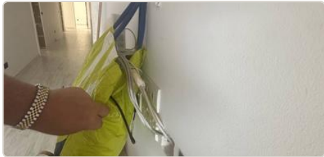
A26 SITE: corridor switch position [MCR]
